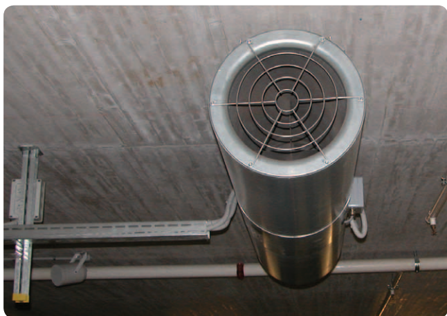
Obr.: Posuvné axiálne ventilátory Systemair AJR 315-2/4 JET v celkovom počta 134 ks slúžia na rovnomerné prevetrávanie dvoch podzemných garáží
