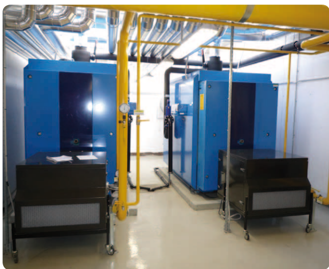
Obr.: Nízkoteplotné plynové kotle Buderus LOGANO SE 735 spoločnej kotolne pre bloky A+B, menovitý tepelný výkon kotla á 1400 kW. Inštalovaný výkon je 2800 kW
